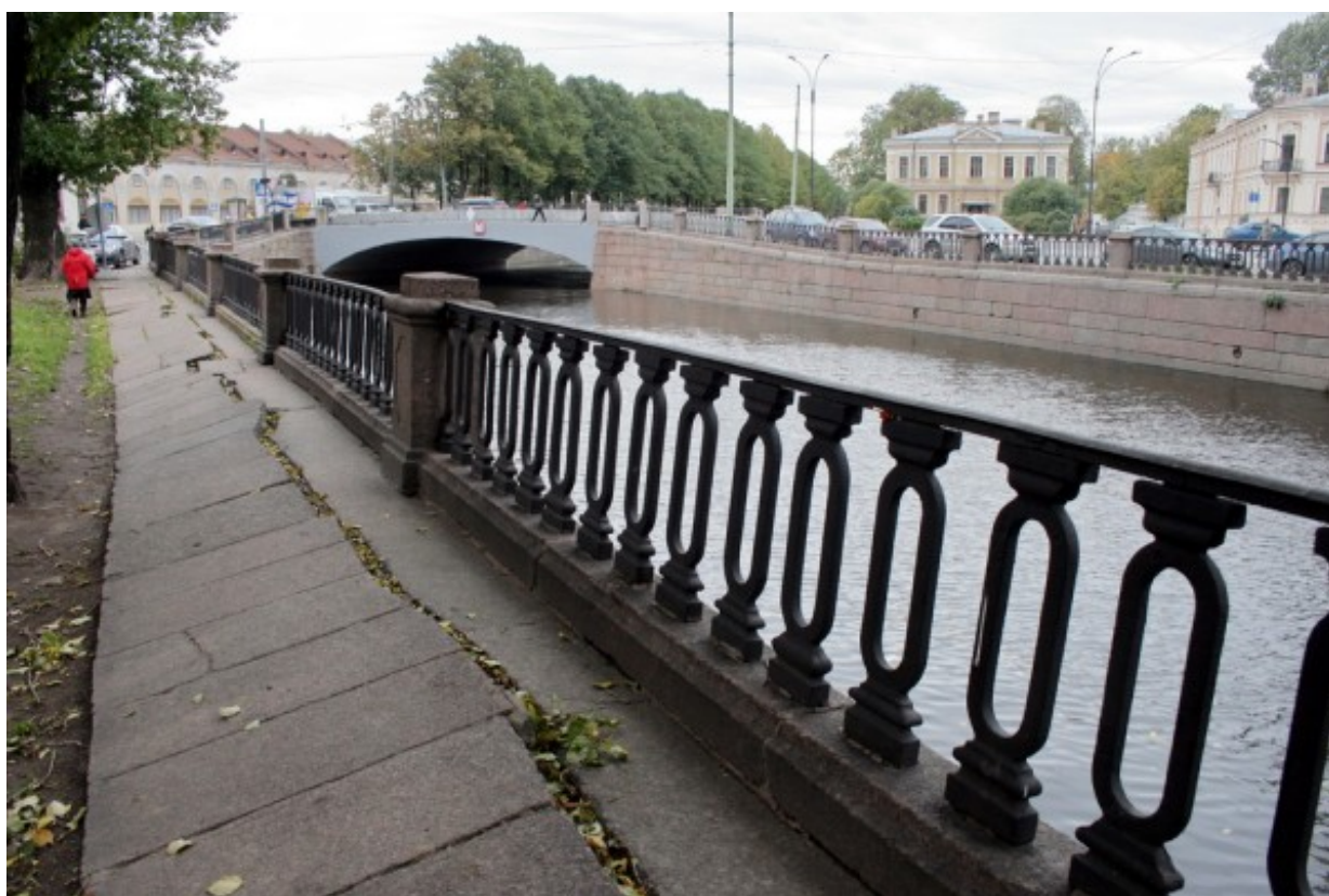
Рис. 3. Деформация тротуарных плит. Набережная канала Грибоедова. 2009
